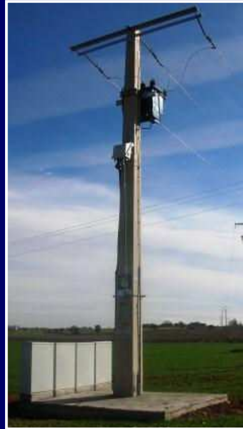
▲ CT de intemperie sobre apoyo ▲
