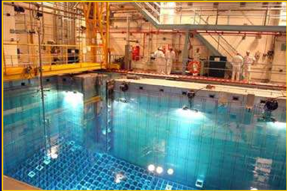
Piscina de la central de Almaraz
