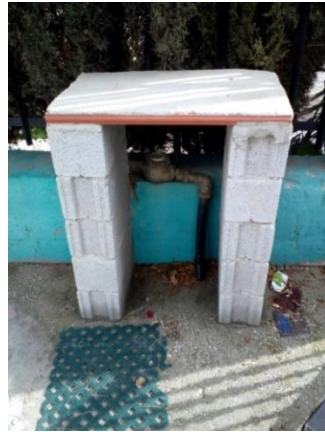
Acometida junto a la entrada principal
