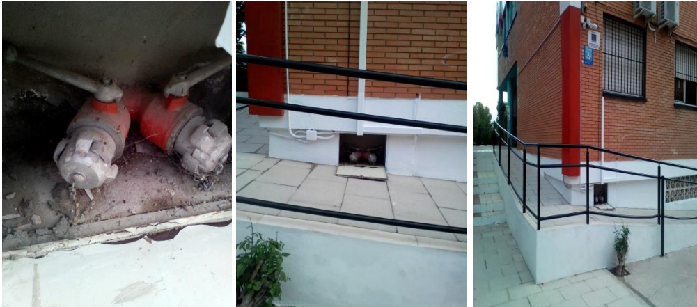
Ubicación de la conexión de la columna seca del centro, entrada principal
