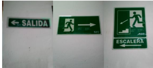
Señales indicativas del centro
