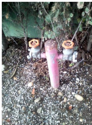
Toma de manguera de incendios
