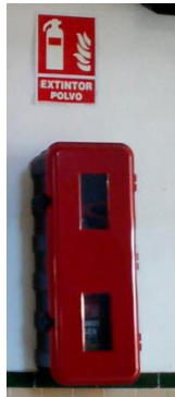
Extintor Polvo ABC
