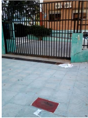
Boca de incendios exterior
