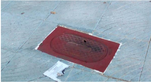
Boca de incendios
