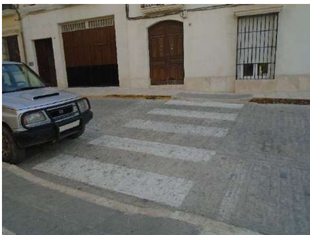
Ausencia de pavimento táctil en calle Veracruz.
