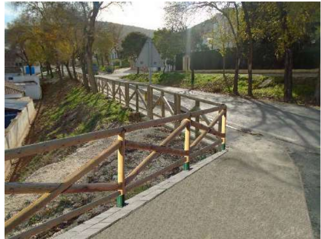
Fotomontaje. Instalación de vallas peatonales en calle Las Encinas, intersección con avda. España.
