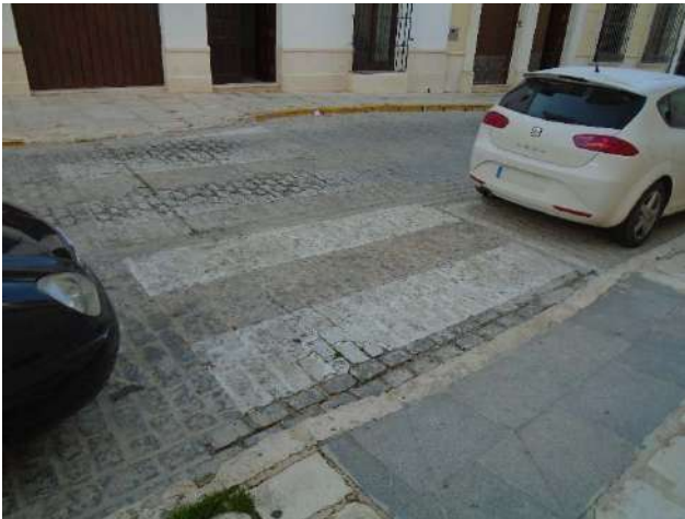
Paso para peatones susceptible de mejora, así como mejora de la accesibilidad del acerado en calle Veracruz.
