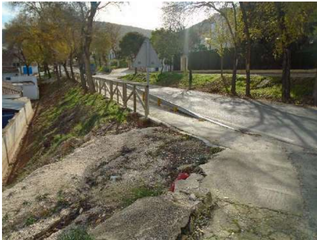
Desnivel sin protección en calle Las Encinas, intersección con avda. España.
