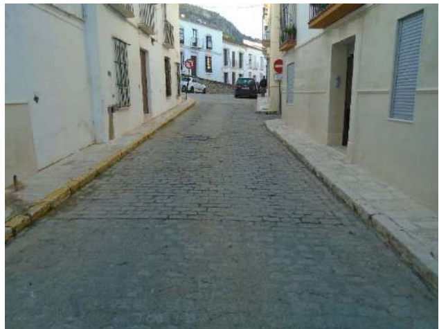
Necesidad de rebaje y pintado de paso peatonal en calle Cardenal Spínola.
