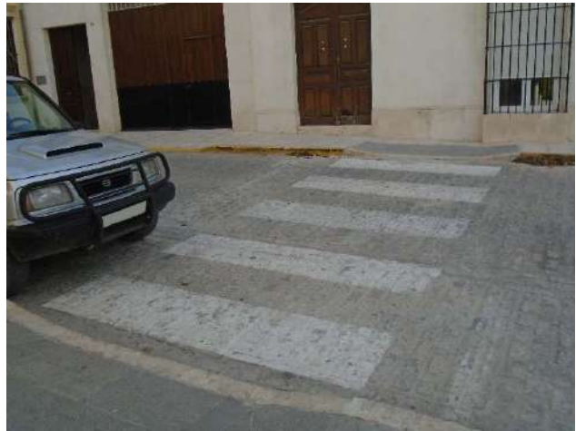
Necesidad de mejora de la accesibilidad en rebaje de acerado en calle Veracruz.
